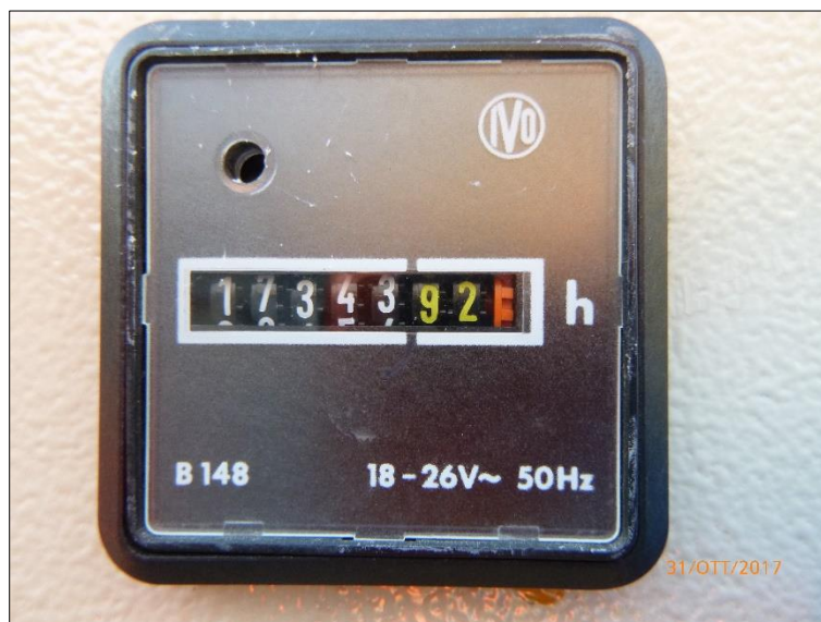
Foto 2: contatore pompa Lago di Cava – 31 ottobre 2017
